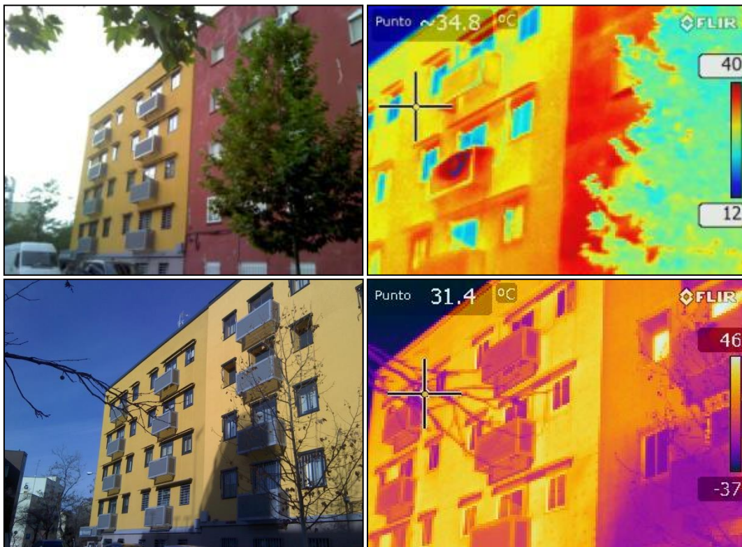
Ilustración 3. Termografías de la fachada trasera del edificio antes (arriba) y después (debajo) de la implementación de las medidas
