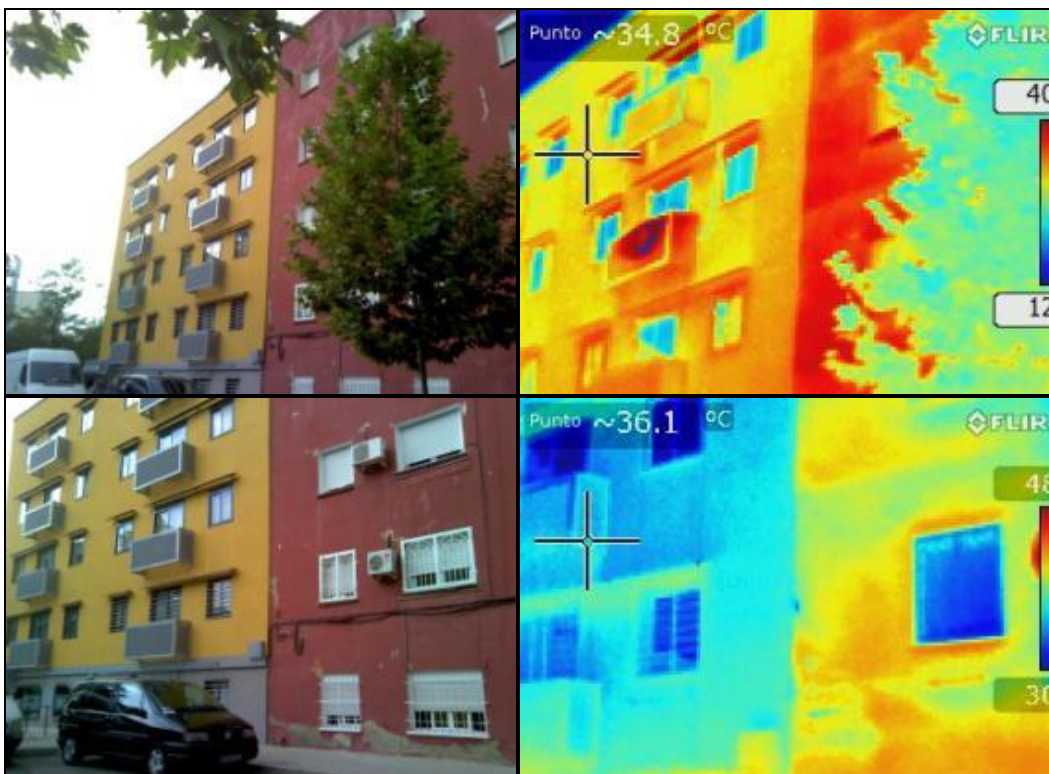
Ilustración 13. Termografía comparación fachada aislada (a la izquierda)/fachada sin aislar (a la derecha).
