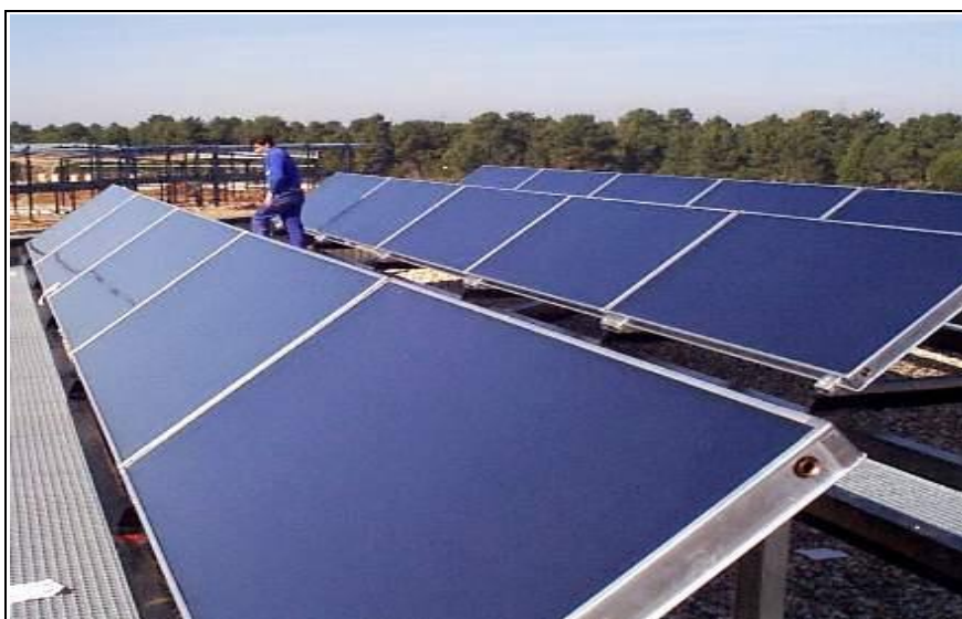
Ilustración 27. Colectores de placa plana.
