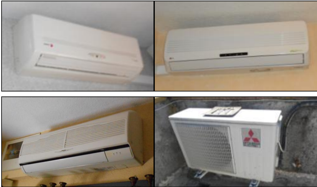
Ilustración 4. Bombas de Calor
