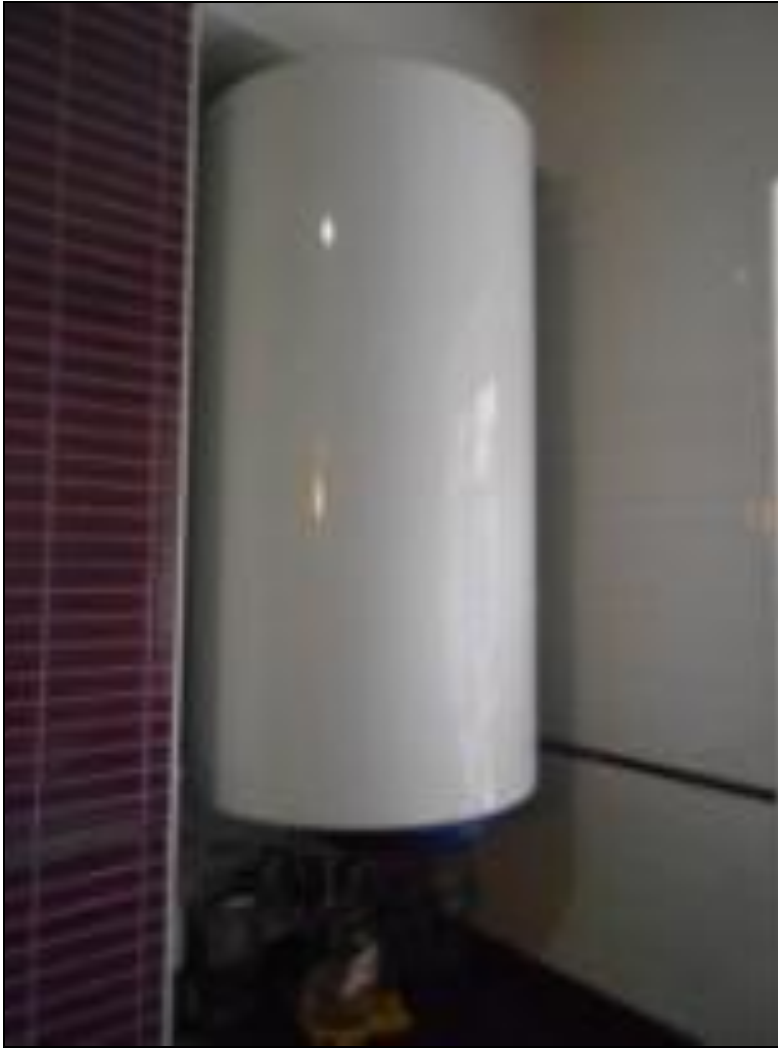
Ilustración 7. Termo de agua caliente sanitaria.
