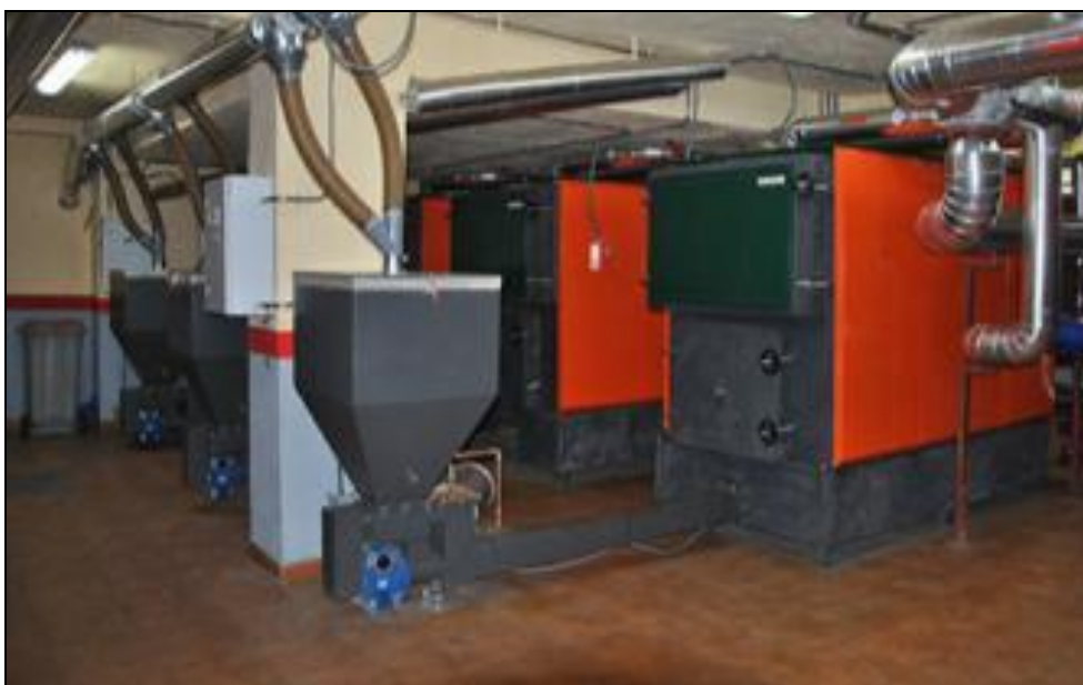
Ilustración 30. Caldera de Biomasa.
